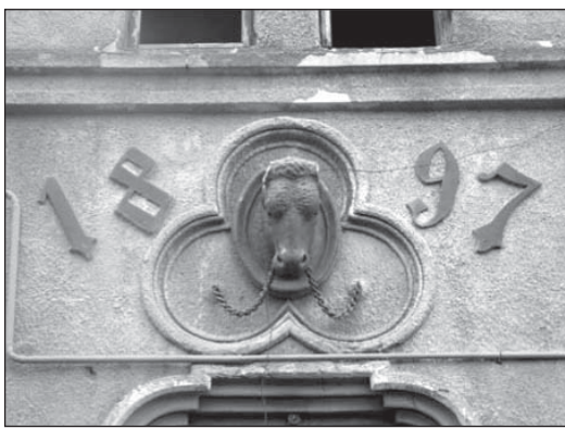
Будівля бойні по вул. С.Людкевича. Оздоблення ліпниною над головним входом. Фото 2009 р.
