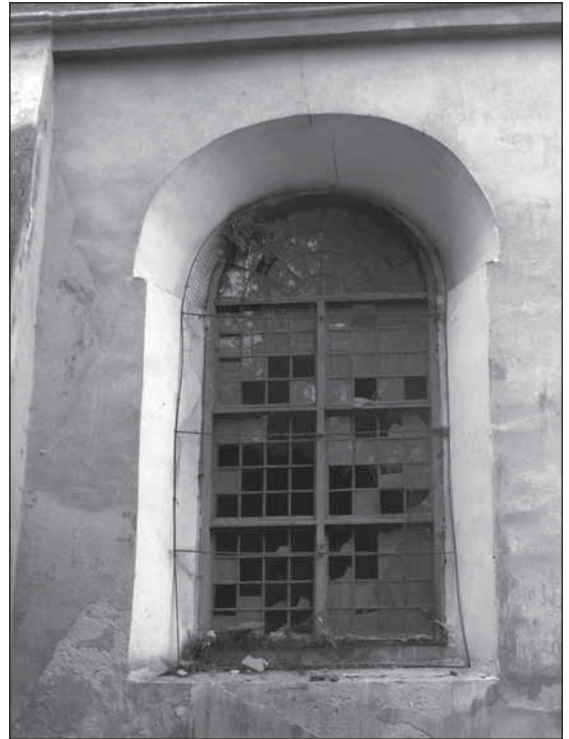
Рис. 31. Сліди від пониження вікна на північному фасаді. Фото 2008 року
