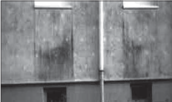
Фото 1. (з журналу «Bautenschutz+Bausanie-rung», січень 2002). Теплоізоляція стіни, покрита пліснявою і лишайниками
