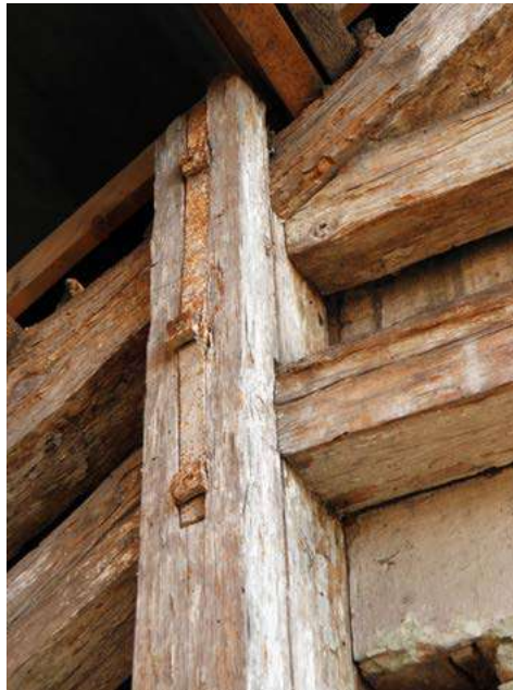
Іл. 19. Споруда історичного манежу. Дахові конструкції. Кроквяна ферма. Брус підвісної бабки закріплений до бруса кроквяної ноги залізними хомутами і болтами. Фото автора, 2020 р.
