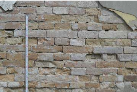
Іл. 13. Споруда історичного манежу. Бічний західний фасад. Зондаж мурування стіни. Розміри цегли 65÷68 x 145÷150 x 288÷305 мм. Фото автора, 2020 р.
